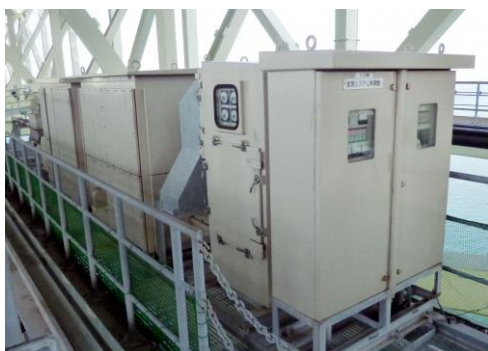
送気用機械設備
