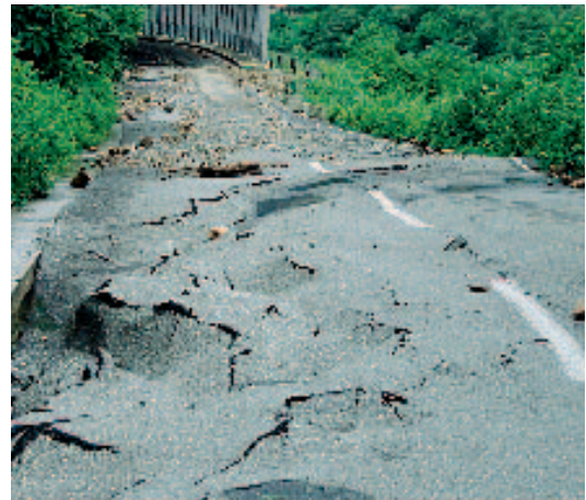
梅雨前線豪雨による被災状況 国道252号（只見町田子倉地内）
